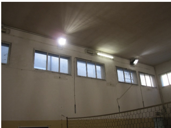
Figura 4.12 - Particolare dei corpi illuminanti ubicati nella palestra
