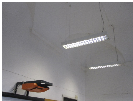
Figura 4.11 - Particolare dei corpi illuminanti ubicati nelle aule.
