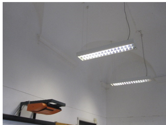
Figura 8.8 - Particolare impianto illuminazione su cui intervenire.
